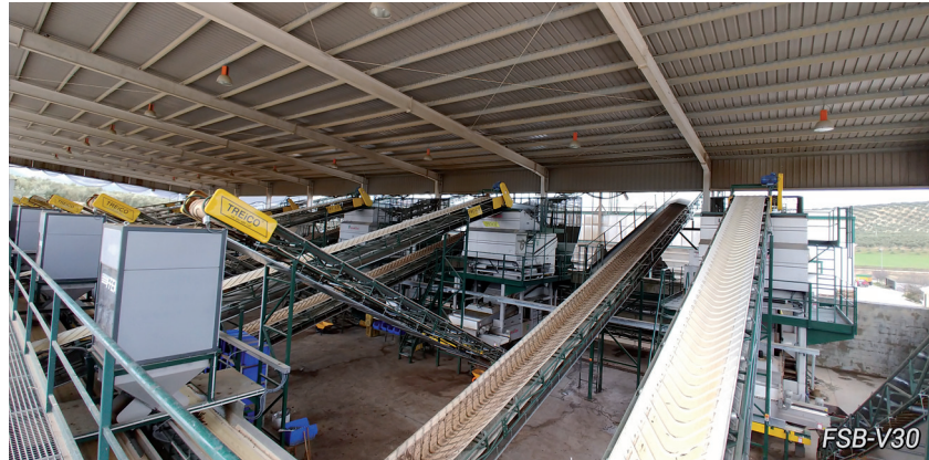
El cerramiento de las tolvas de recepción, una de las principales inversiones.
